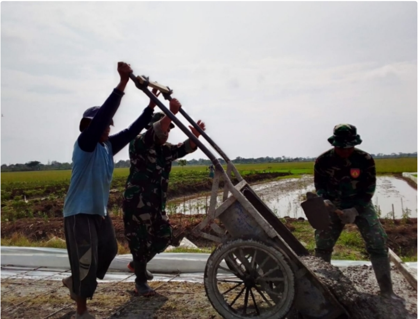
Giat Anggota Satgas TMMD dan Masyarakat Kebut Pengecoran Jalan Pertanian Desa Rejosari Kecamatan Mijen
